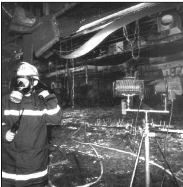
Požiar PVC káblov v telefónnej ústredni v Dusseldorfe r.1988 bol ľahko zahasený pomocou iba 10 litrov vody, ale mal za následok ťažkú kontamináciu celej budovy dioxínmi. Tri roky prebiehalo odstránenie znečistenia v cene 12 miliónov dolárov!
